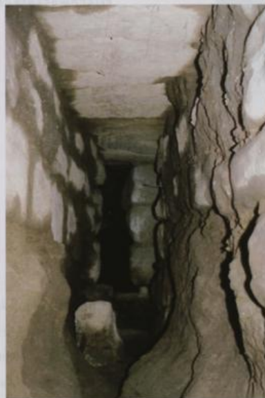
Abb. 14: Kanal unter der Kuretenstraße mit flacher Decke. Der Blick zurück zeigt nicht eine Engstelle im Kanal, sondern einen Teil des großen Pfeilers in der Sickerkammer (siehe Abb. 24–26)
