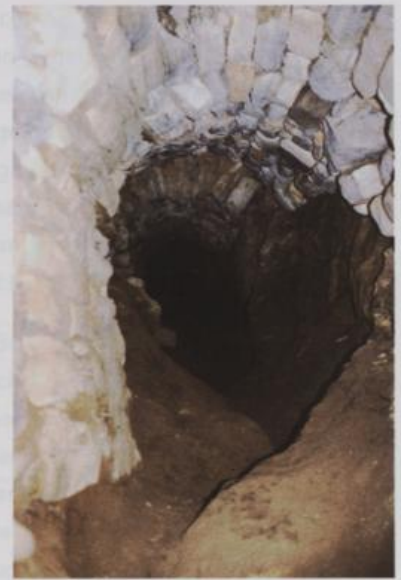
Abb. 12: Abwasserkanal unter Stiegegasse 1, wobei das Wasser den Glimmerschiefer stark ausgeschwemmt hat, so dass die ursprüngliche Kanalsohle nicht mehr erkennbar ist
