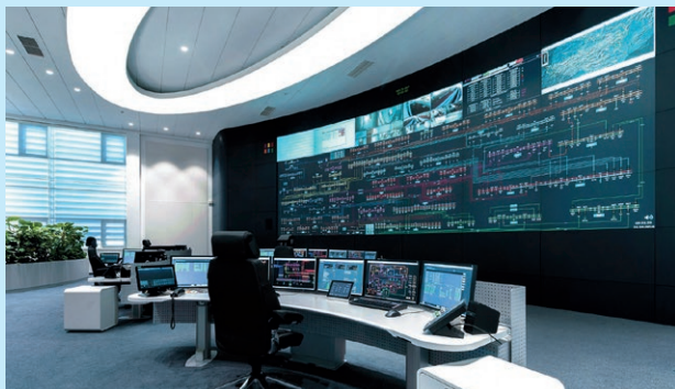
Leitwarten-Cluster am Smart Campus Simmering
