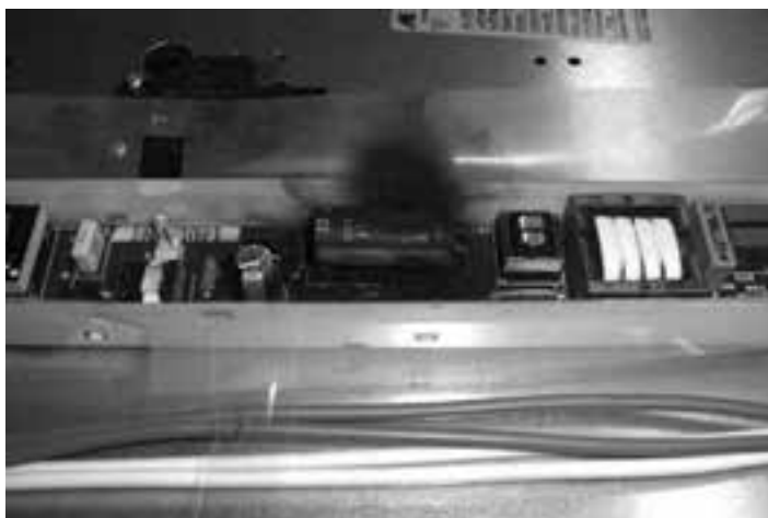
Abb. 1.: Beispielbild eines zerstörten elektronischen Vorschaltgerätes
