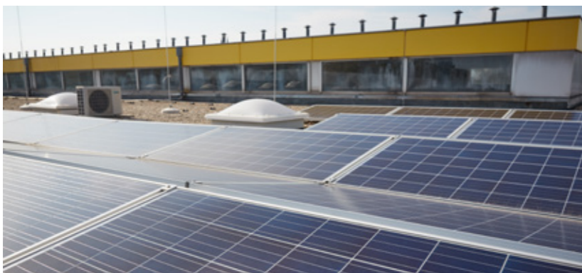
Längst smart in Sachen Energiegewinnung: Im Hietzinger Bad und an einigen anderen Standorten der MA44-Bäder wird mit Photovoltaikanlagen Strom erzeugt.
