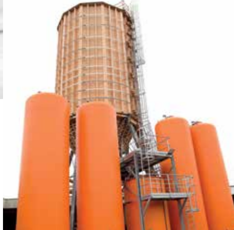
Leistungstärkste Soleanlage der Welt
