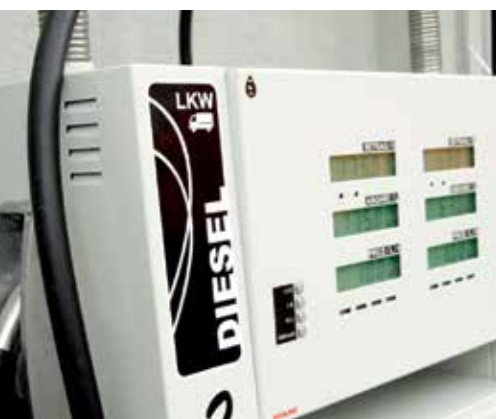
Die Tankstellen in Margareten und Hernalds wurden mit einer Notstromversorgung ausgestattet.
