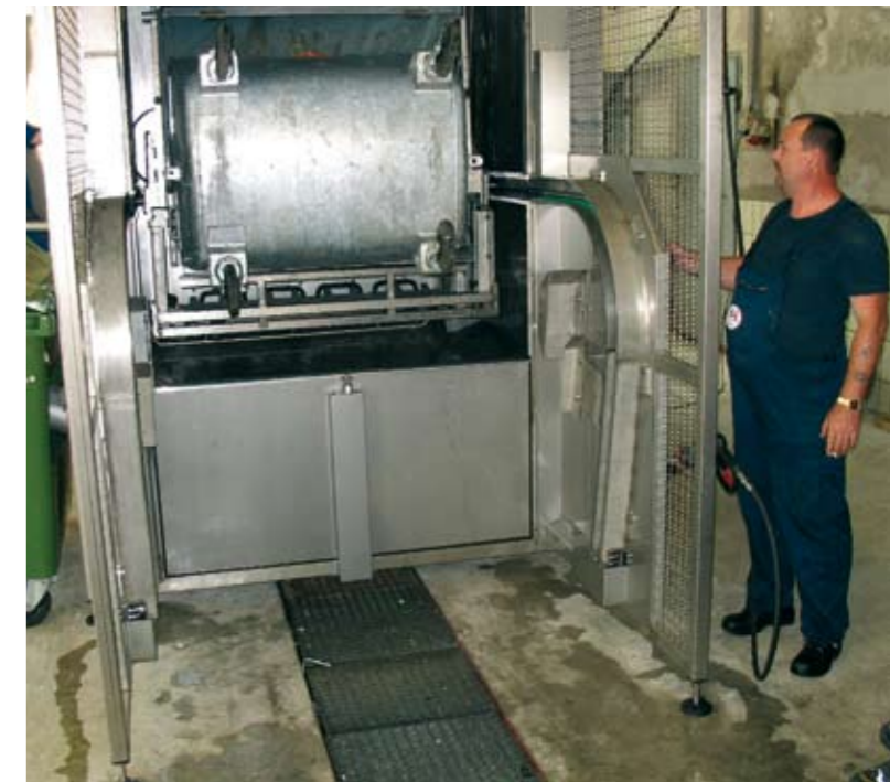
Inbetriebnahme der neuen Behälterwaschmaschine
