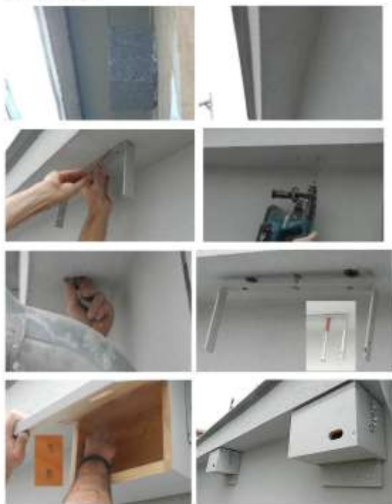
Abbildung: Mauersegler-Nistkasten nach oben in wärmedämmtes Vordach montiert: a) Situation vor Sanierung mit Dämmmuster b) Vordach gedämmt, c) Anzeichnen Nistposition d) Bohren der Löcher (mittleres Loch Abstützung) e) Einstoßen der Distanzhölzer (Hohlzylinder) f) Situation vor Schraubensetzung nach oben, g) Einsetzen des Nistkastens mit Flachkopfschrauben h) Befestigung mit Flügelmutter, Endstopkappe
