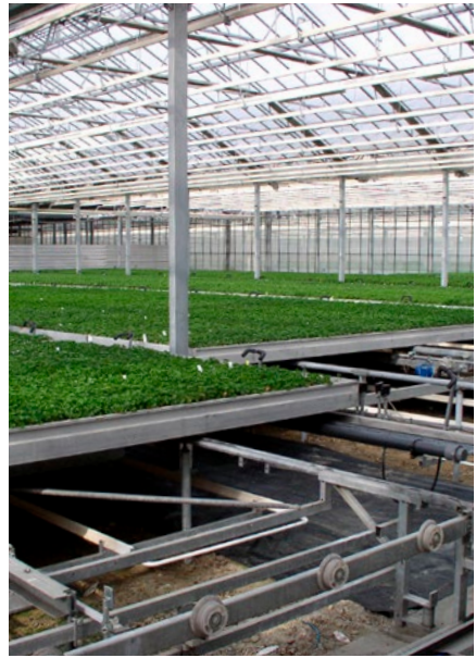
Tischkonstruktion im Gewächshaus
