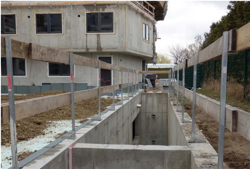
Foto 13 Tiefbeet im Lichtatrium: unterirdisch geführte Zuläufe, Verbindungsrohr zum Retentionsraum im benachbarten Tiefbeet
