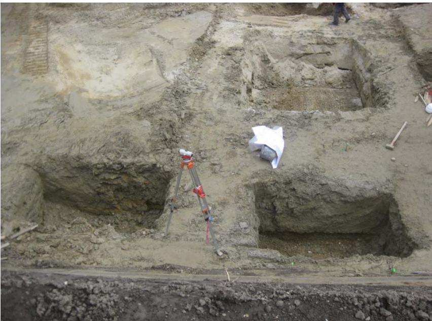
Foto 4 Baugrube: Blick nach N: von der Baugrubenkante bei der Fundergasse aus Schluffe und Feinsande unterlagert von Kiessanden
