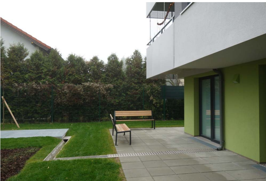
Foto 17 Dachableitung in außenliegenden Fallrohren und Betonhalbschalen durch Eigengarten zum Tiefbeet im Lichtatrium; Abdeckung der Halbschale im Bereich der Terrasse
