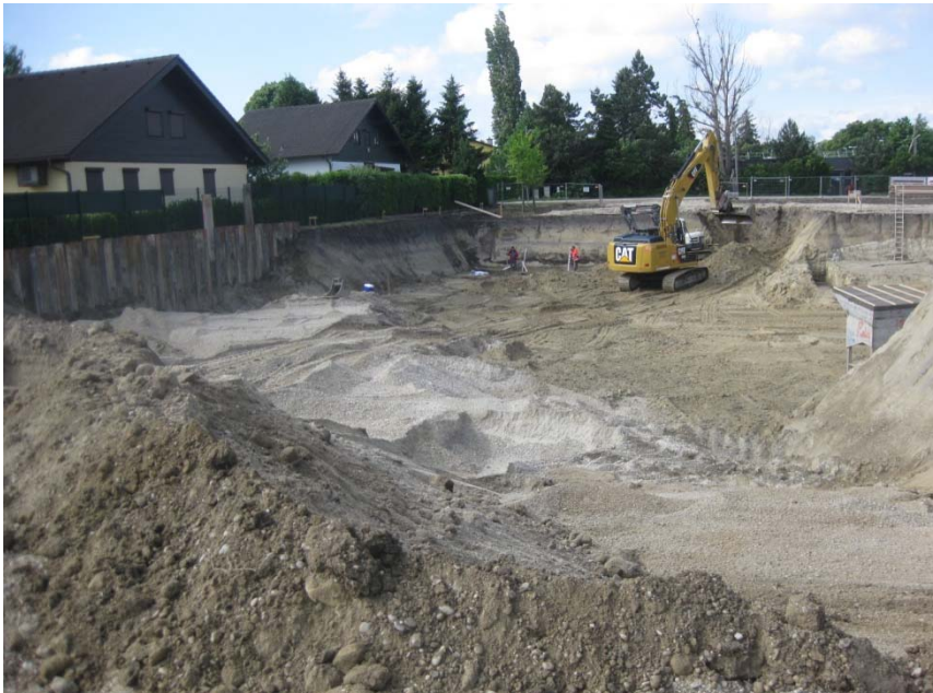
Foto1 Baugrube: Blick nach S in Richtung Fundergasse Im Vordergrund Baugrubensohle mit durchlässigen Kiessanden
