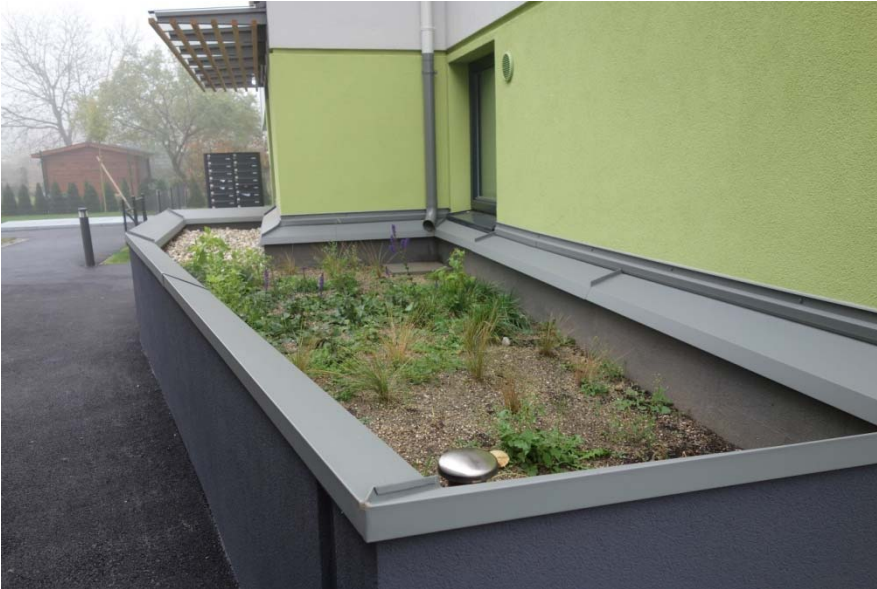
Foto 20 Retentionsraum „Sumpfbeet“: Einleitung Fallrohr, im Vordergrund Abdeckung des Notüberlaufs
