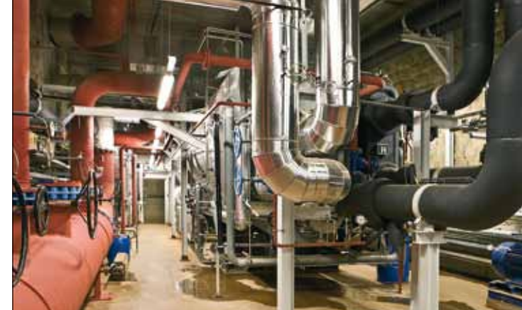
© WIENER ENERGIE FERNWÄRME/CH. HOUDEK
