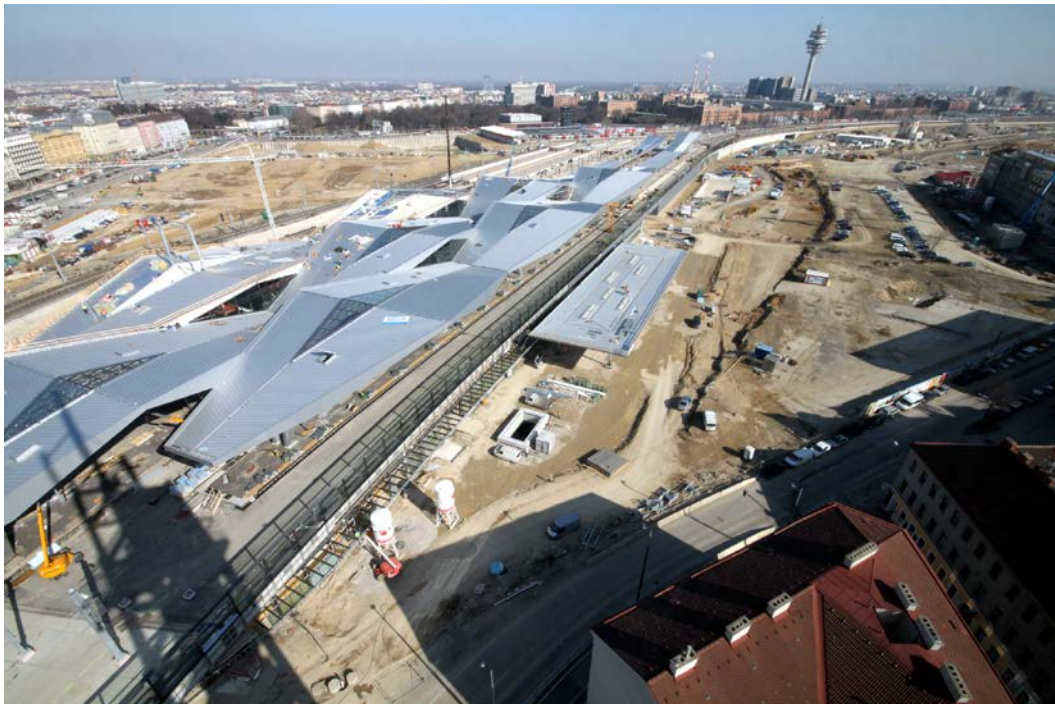
Der Bau des Daches des dritten Bahnsteigs ist weit fortgeschritten. Mit der Teileröffnung des Bahnhofs heuer im Dezember werden drei Bahnsteige überdacht sein. Das riesige Dach am Vorplatz Süd, in Bildmitte, ist ebenfalls fast fertig. Durch die große Öffnung im Boden davor soll zukünftig Tageslicht ins Atrium der Shoppingebene darunter dringen
