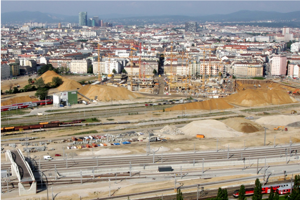
Am Baufeld C.01, ganz rechts, wird gerade die Baugrube ausgehoben, auf den Baufeldern C.02 und C.03, links anschließend, wird bereits der Hochbau aufgezogen. Die mächtigen frischen Erdhügel sind von guter Materialqualität und werden für den Unterbau des Parks verwendet. Links vorne ist das Brückenfragment des zukünftigen Arsenalstegs zu sehen
