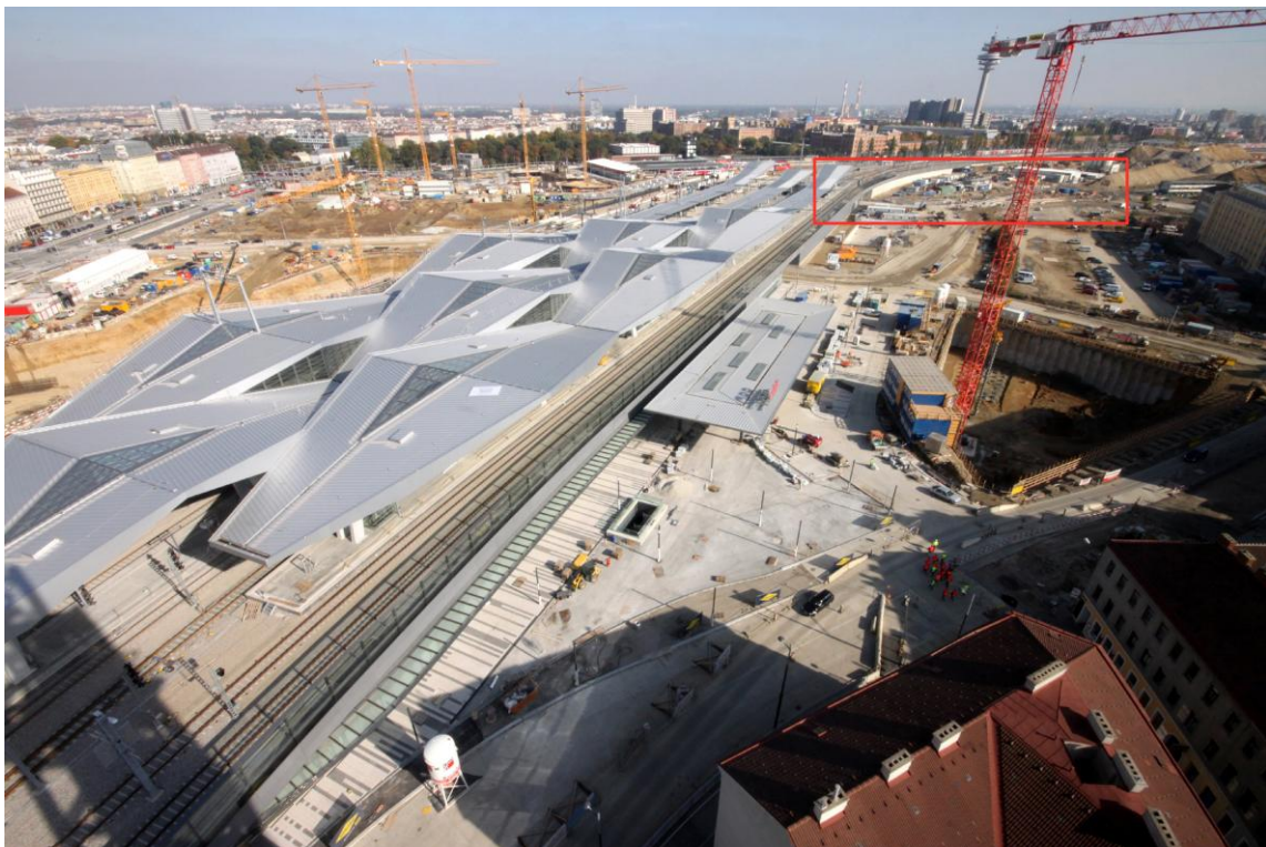
Drei Bahnsteige sind bereits komplett überdacht, der Vorplatz Süd mit dem großen Vordach ist im Fertigwerden. Links mittig ist die Baugrube der Bahnhofshalle zu erahnen. Die tiefe Baugrube rechts kennzeichnet die Lage der zukünftigen ÖBB-Zentrale, das rote Rechteck die neue Umkehrschleife des D-Wagens
