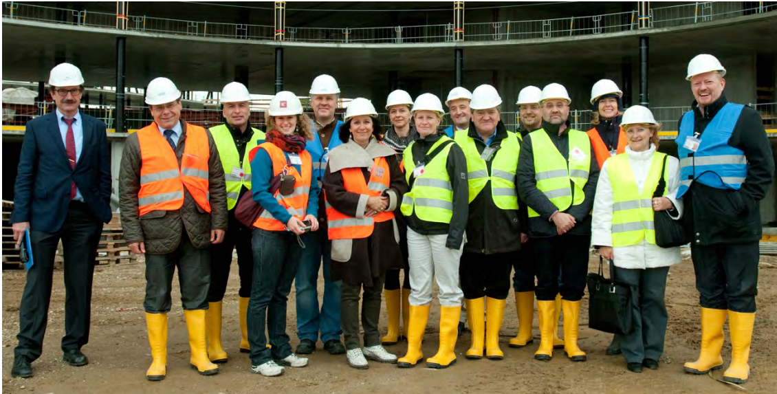
Erste Bank-Vorstandsvorsitzender Richard Wilkinson (1. v. r.) und Erste Bank-Projektleiter Michael Hamann (7. v. r.) führten Frau Stadtbaudirektorin Brigitte Jilka und die Kolleg/-innen der Stadtbaudirektion durch die Baustelle
