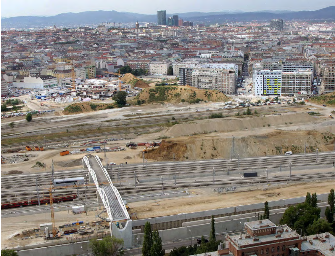
Links hinten ist der schon weit fortgeschrittene Rohbau des Bildungscampus zu sehen, rechts die beiden Wohnbauten, die jetzt bezogen werden. Im Vordergrund liegt der Arsenalsteg nach der Einhebung des zweiten Brückenteils
