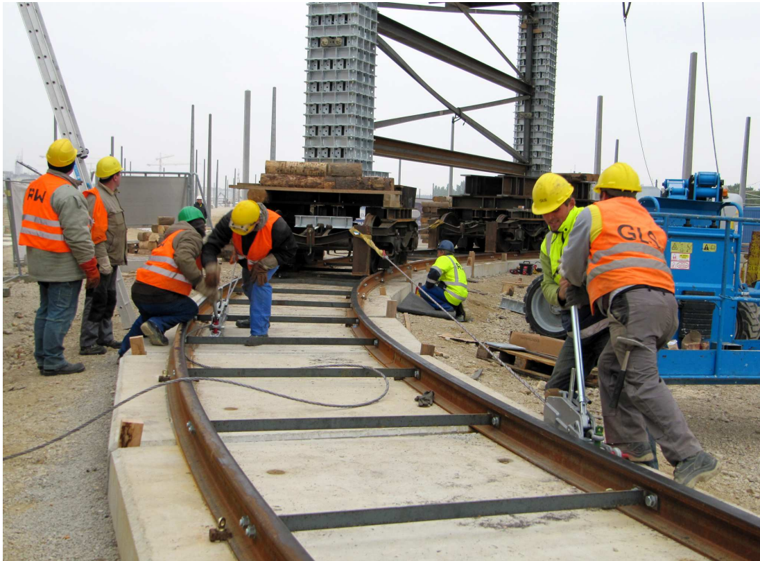
Mit viel Körperkraft und mit Hilfe von Greifzügen wird die gewichtige Brücke in Millimeterarbeit in Position gebracht
