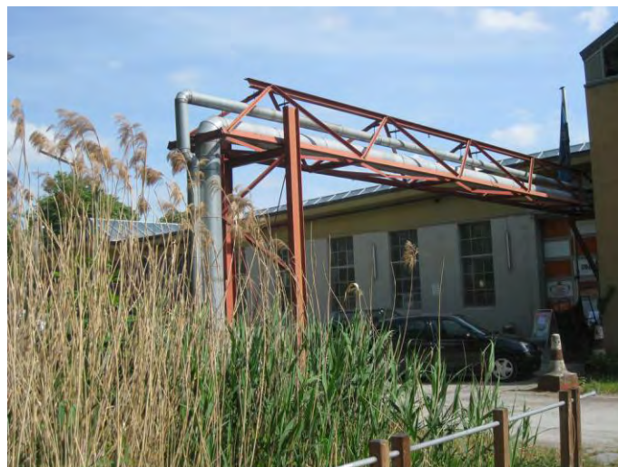
Abb. 75 Rohrbrücke zur Ableitung des Regenwassers (Foto: Büro Grimm)
