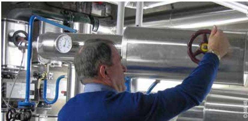
Technikraum der neuen Heizanlage
