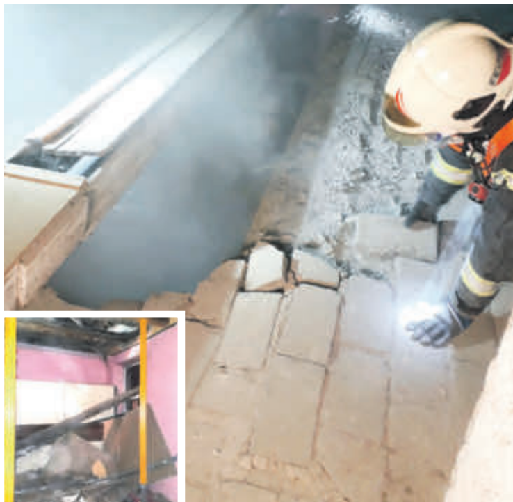
Ein Mitarbeiter der Wiener Berufsfeuerwehr untersucht das durch den Deckeneinsturz entstandene riesige Loch.
