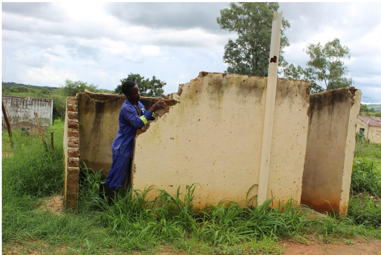
Sanierungsbedürftige Toiletten. Foto: HUMANA
