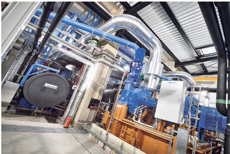
In Simmering steht Mitteleuropas leistungsstärkste Großwärmepumpe.
