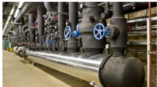
Fernkältezentrale Spittelau, Kälteverteiler © Wien Energie Fernwärme
