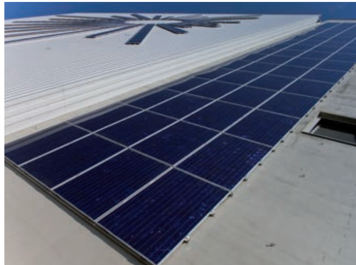
Photovoltaikanlage Kraftwerk Simmering 1 © Wien Energie
