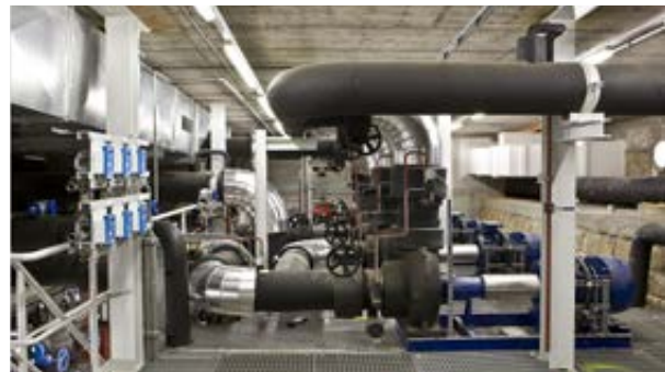
Fernkältezentrale Spittelau, Kältepumpen © Wien Energie Fernwärme
