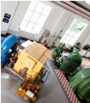
Maschinenhalle Trinkwasserkraftwerk Gaming 1 © Wien Energie
