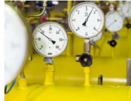
Erdgasverteil- und Regelsystem © Wien Energie Gasnetz
