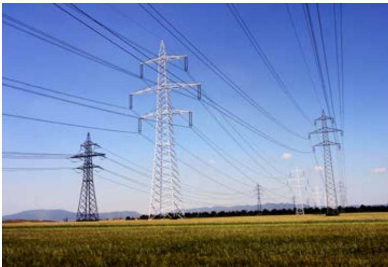
Freileitungen 400 kV Wien Südost © Hans Prammer, Wien Energie
