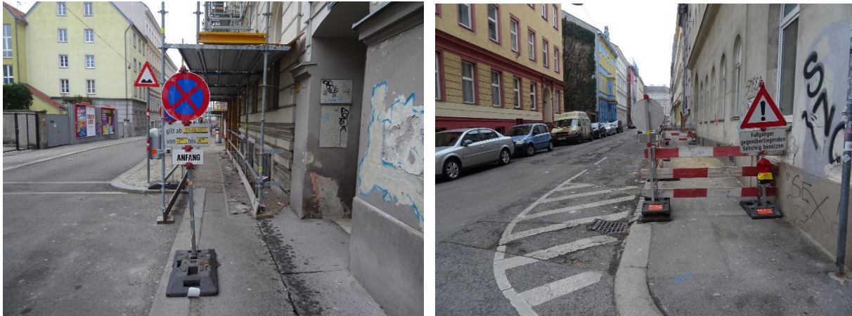
Abbildung 30 Stolperfalle Baustellengerüst und Umleitung
