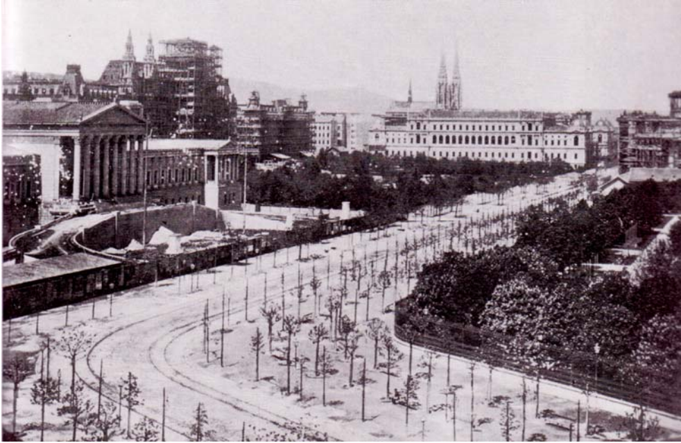
Abb. 3: Die neu angelegte Ringstraße mit den Baustellen Parlament, Rathaus, Universität und Burgtheater.
