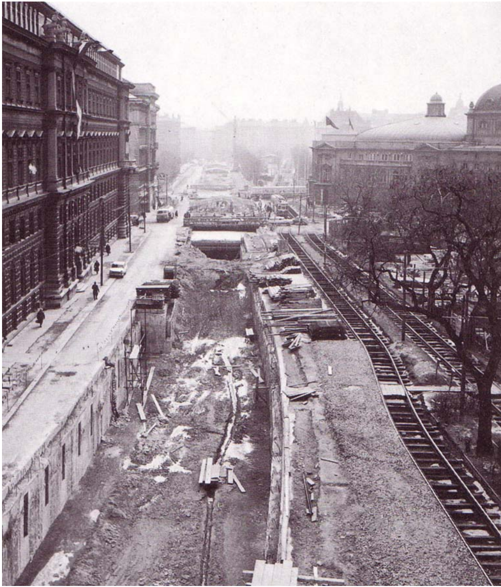
Abb. 32: Umbau der „Lastenstraße“ Mitte der sechziger Jahre für die Ustraba. Quelle: 150 Jahre Wiener Stadtbau- amt, Seite 129
