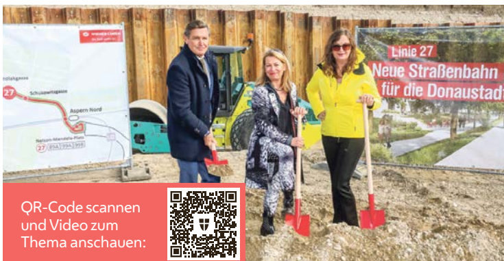
Spatenstich für die neuen Gleise mit Öffi-Stadtrat Peter Hanke, Wiener-Linien-Geschäftsführerin Alexandra Reinagl und Mobilitätsstadträtin Ulli Sima
