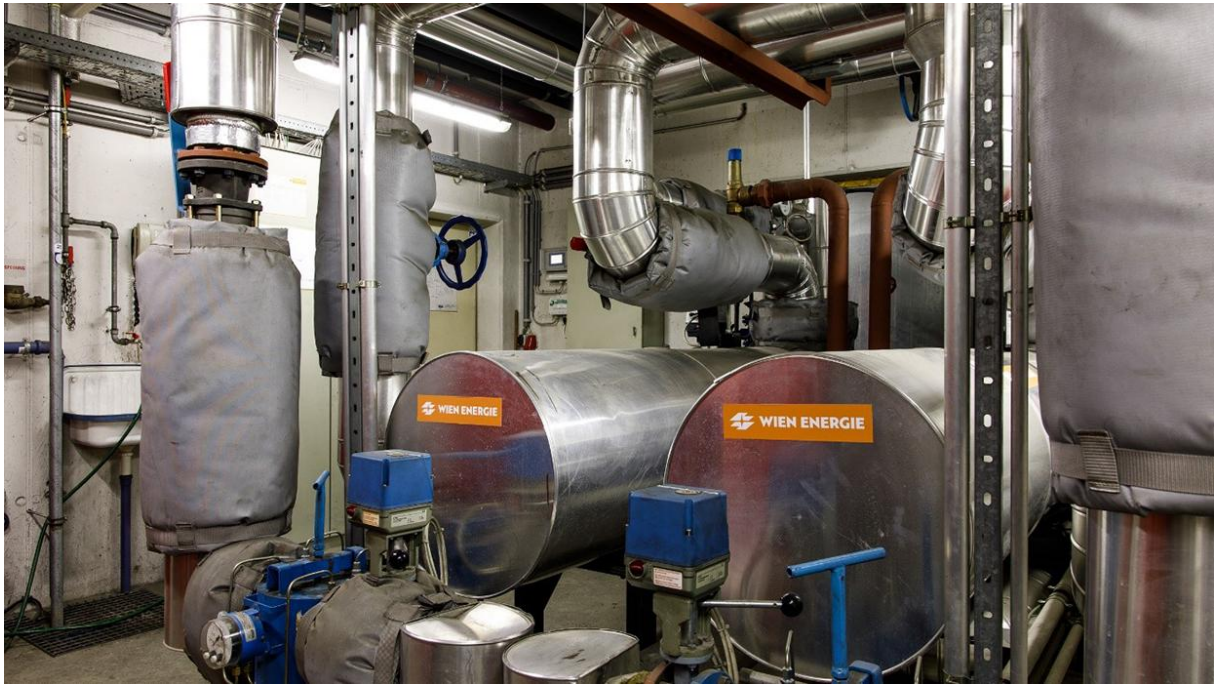
Abbildung 33: Wien Energie-Fernwärme Gebietsumformerstation © Wien Energie/Max Kropitz
