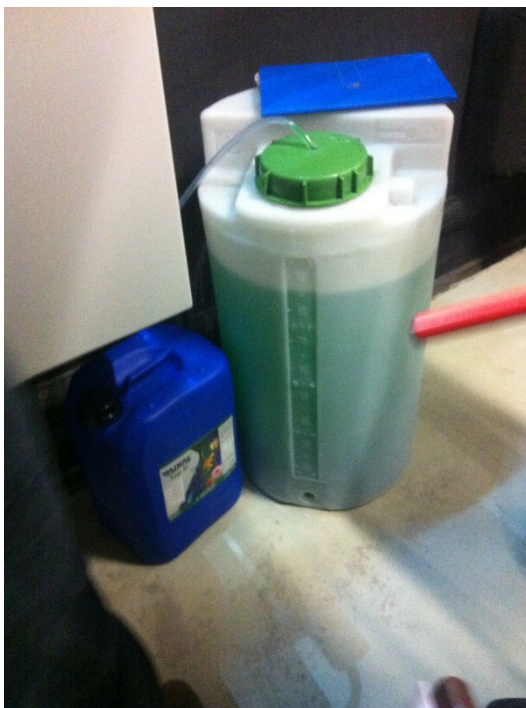
Flüssige Nährstoffversorgung für fassadengebundenes System im Technikraum | Wien | © GREEN4CITIES
