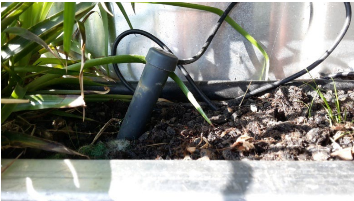
Bodenfeuchte-Sensor in fassadengebundenem System / © GREEN4CITIES
