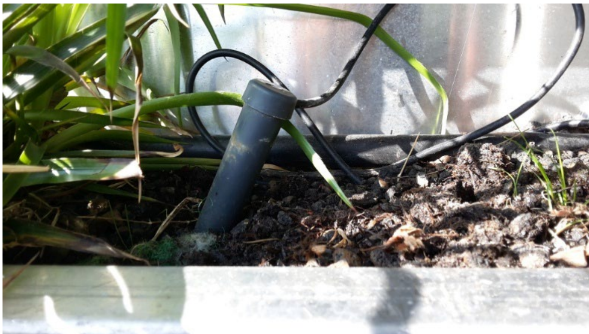
Bodenfeuchte-Sensor in fassadengebundenem System / © GREEN4CITIES
