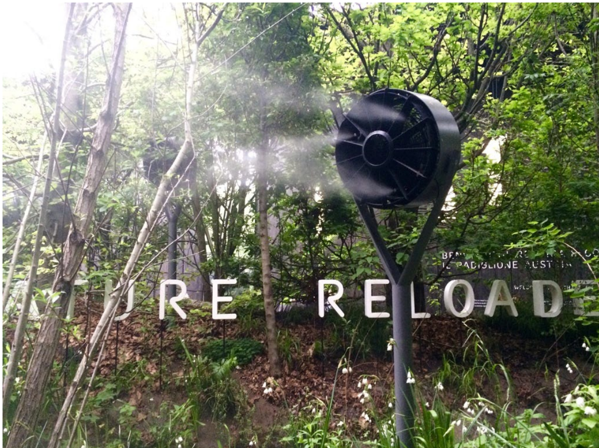
Nebelanlage EXPO Mailand 2015, Österreich-Pavillon, breathe.austria / © GREEN4CITIES
